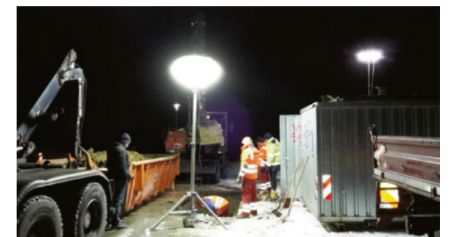
Rohrbruch auf der Falleitung nach Schlaifdorf
